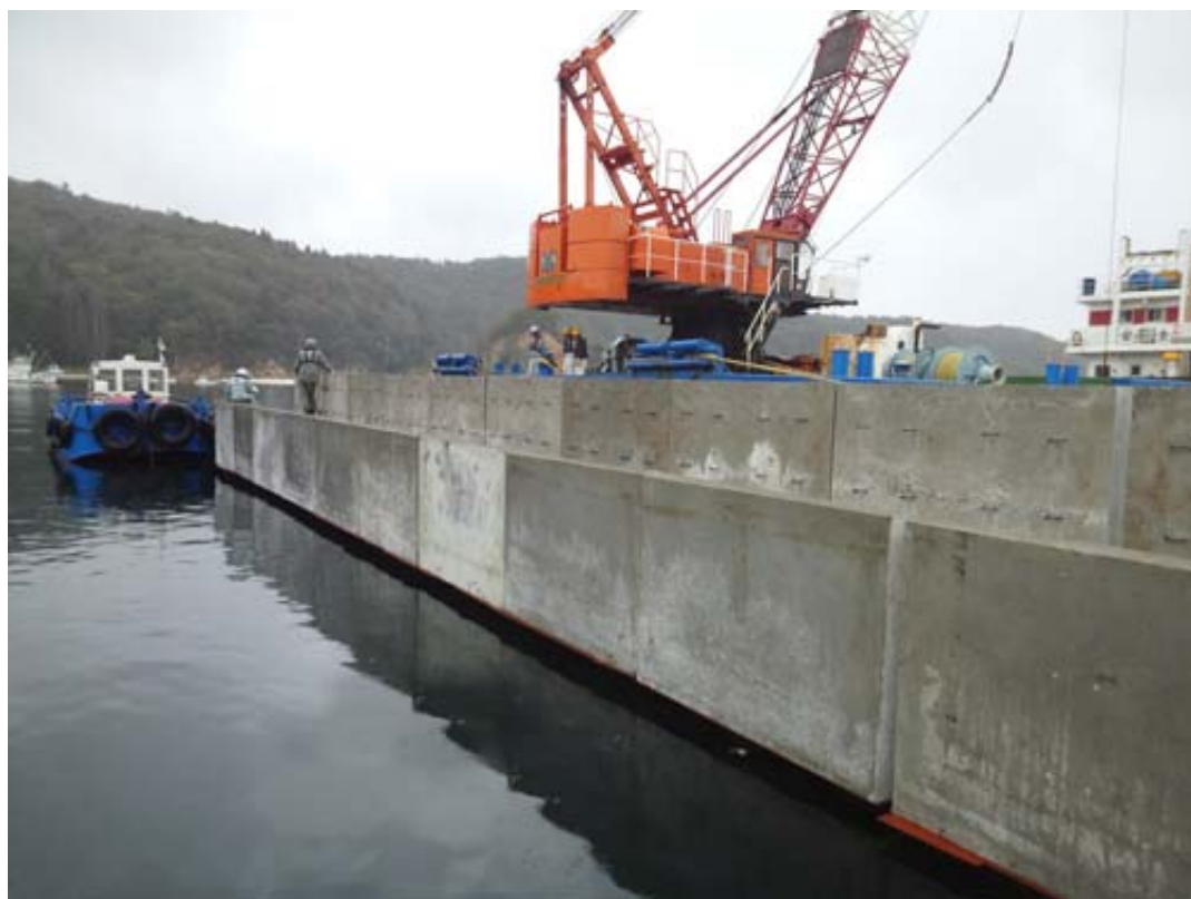
10セットの据付が約半日で完了しました。中詰コンクリートを打設して施工完了です。
