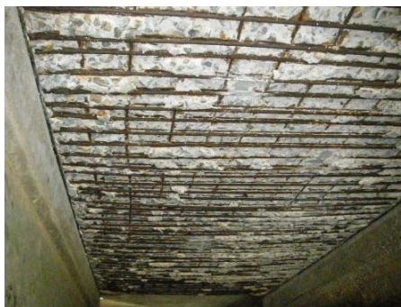
【一般的な塩害劣化の事例】 海岸沿い現場打ち床版の劣化状況（※紹介実績とは無関係）
